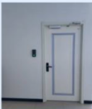
监控&amp;操作台门禁
